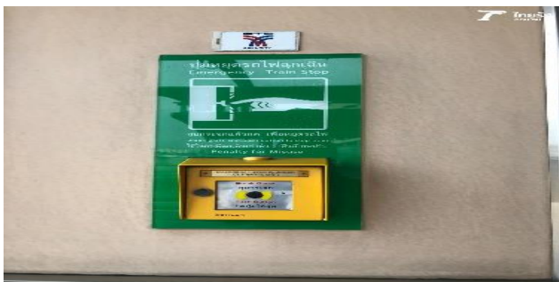
ระบบหยุดรถฉุกเฉิน
